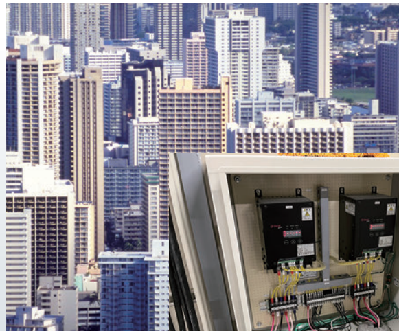
既設直入制御盤とポンプモーターの間に設置しました
